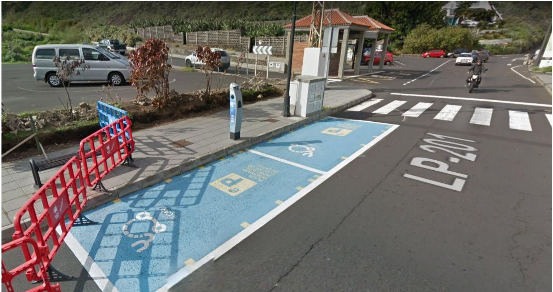
Figura 16: Único punto de recarga de vehículos eléctricos en funcionamiento del municipio.
